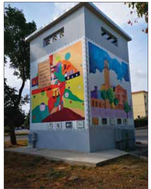
Cabina Enel di via Moro/Claudio, simbolo del quartiere (4.7.2020)
